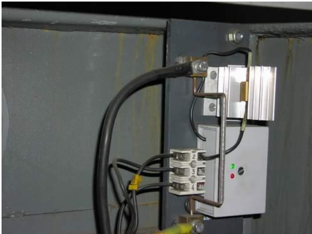
Rys. 2. Regulator RNDZ zamontowany w skrzyni aparaturowej w tylnej części wagonu
